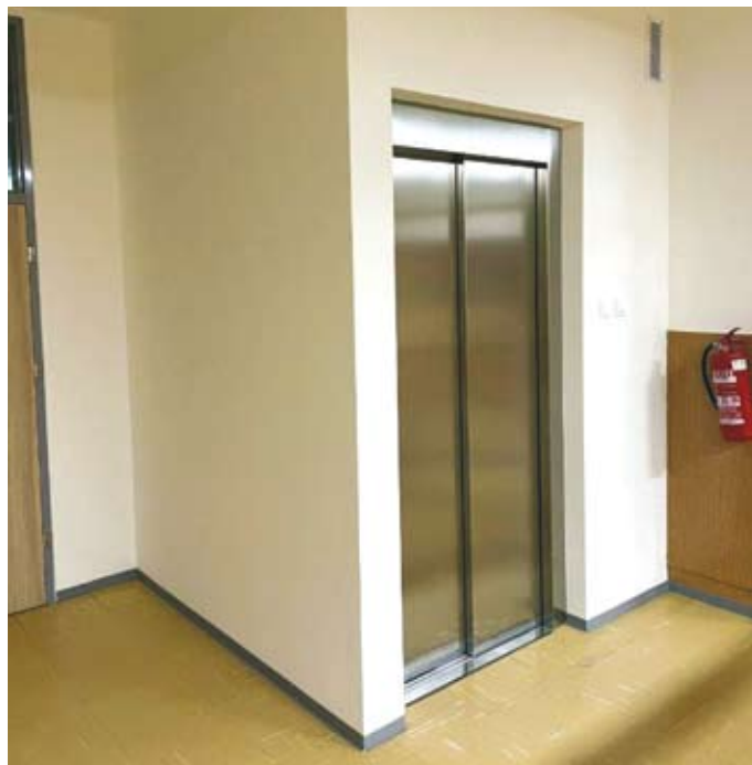
Dvigalo bo v šoli olajšalo delo zaposlenim in omogočilo lažji dostop gibalno oviranim osebam
